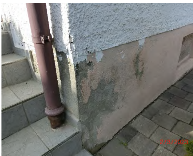
Beispiel baulicher Auffälligkeiten an der Außenfassade / Sockelbereich ...
