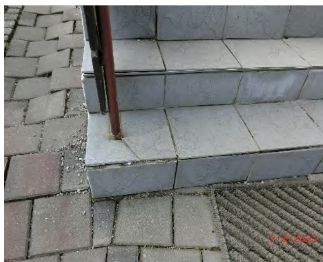
Instandsetzungsbedarf an Zuwegung und Belag Treppenpodest
