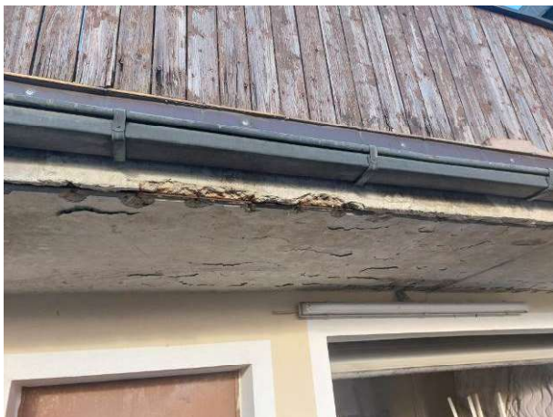
freiliegende Bewehrung der Betondecke
