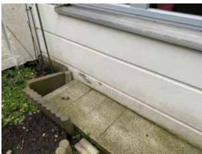
Außenanlage mit exemplarischer Putzfehlstelle
