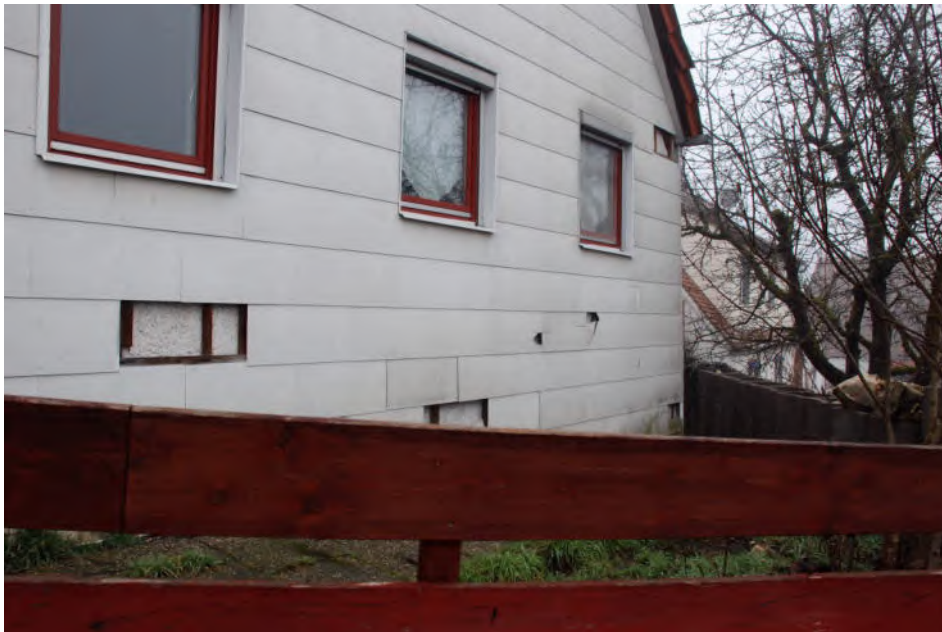
Fehlstellen an der Eternitplattenverkleidung am Ostgiebel
