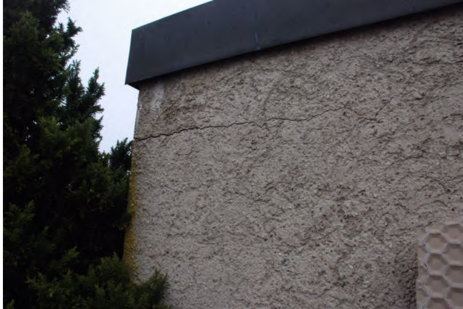
Mauerwerksriß am Deckenaufleger der Garage
