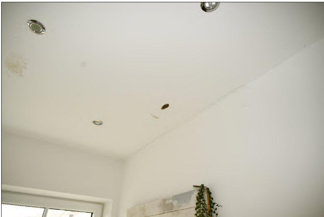
Foto 12 Dachgeschoss - Bad, Feuchtigkeitsspuren an der Decke
