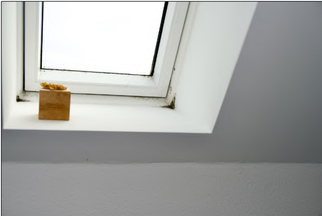
Foto 13 Dachgeschoss - Wohnraum, Schimmelbefall im Bereich des Dachflächenfensters
