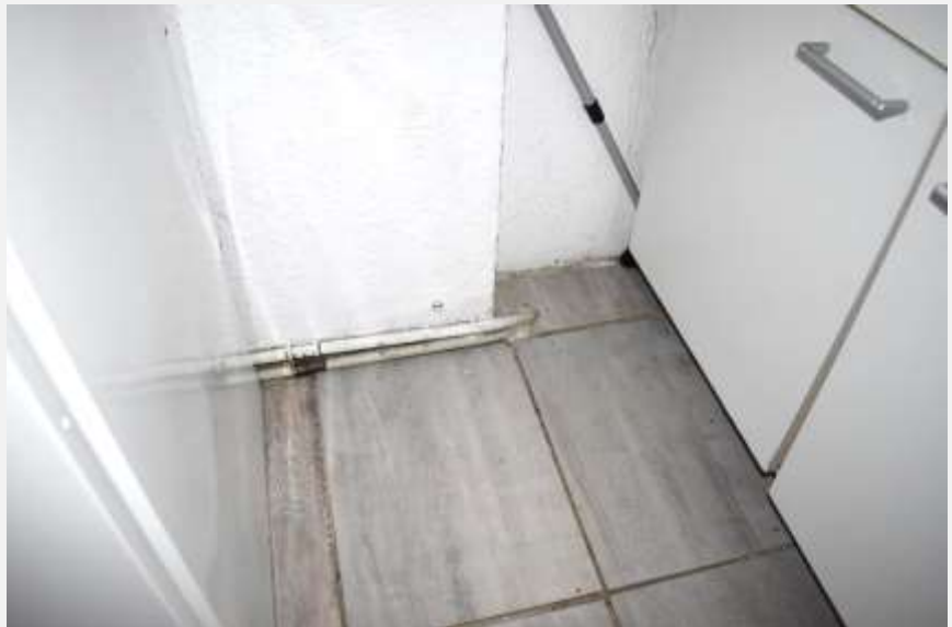
Detail, WEG Nr. 3, sichtbare Installationen
