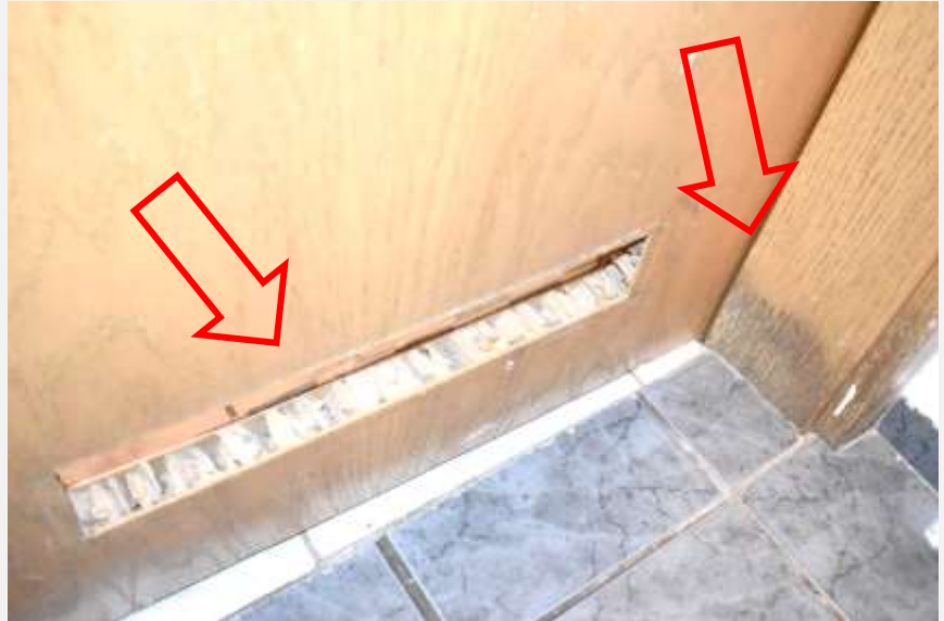
Detail, WEG Nr. 3, beschädigte Innentüren innerhalb der Wohnung
