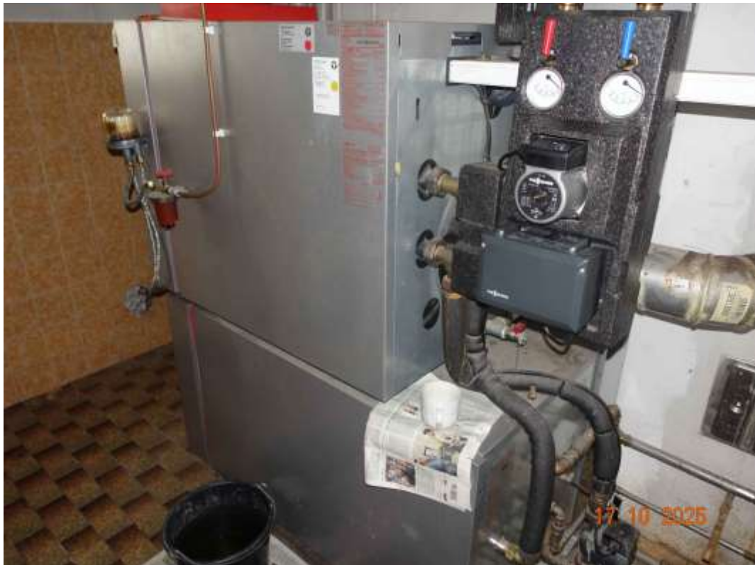
Abbildung 17: Heizkessel von Viessmann aus dem Jahr 2003
