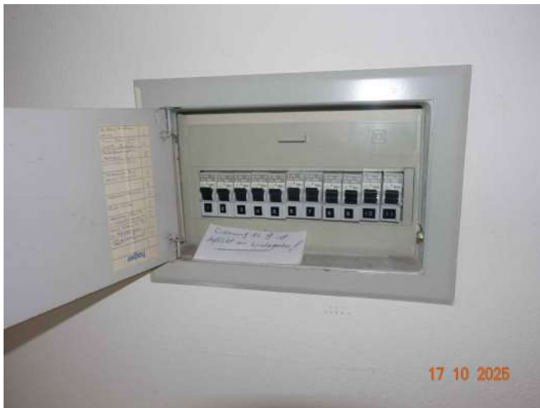
Abbildung 25: Beispiel der Elektrotafelinstallation im Erdgeschoss
