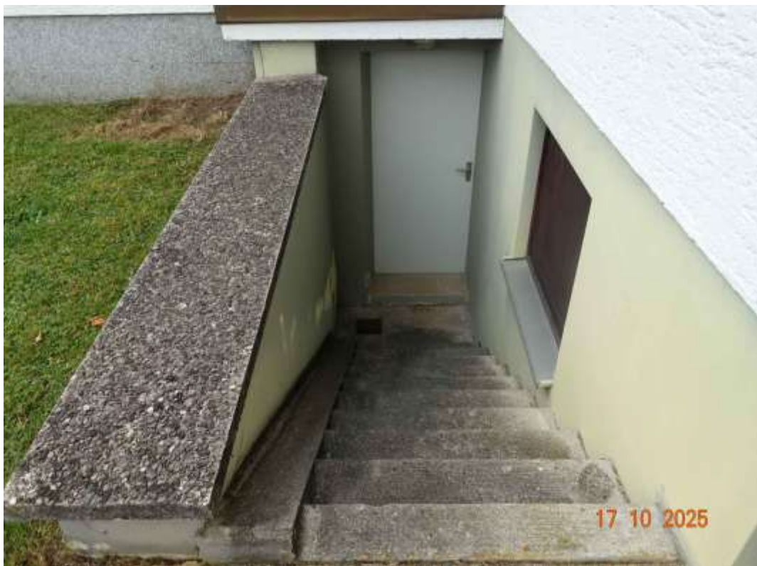
Abbildung 18: Kelleraußentreppe (ohne Handlauf - UNFALLGEFAHR)
