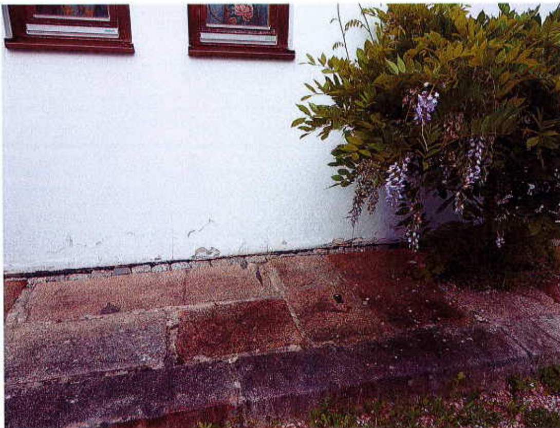
aufsteigende Feuchtigkeit im Sockelbereich
