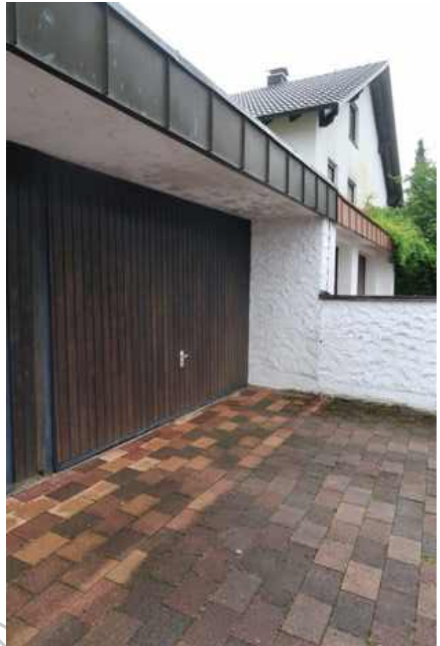
Garagendecke mit Feuchtigkeitsschäden außen
