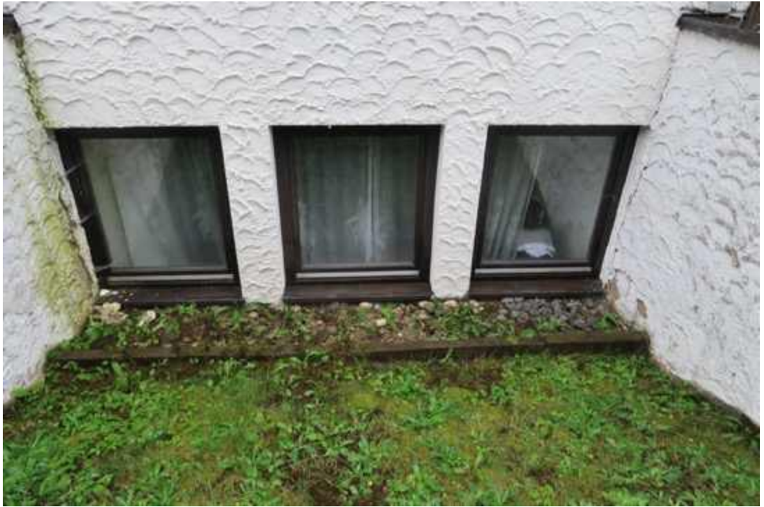
Stützwände der Abböschung zum Keller haben sich gesenkt
