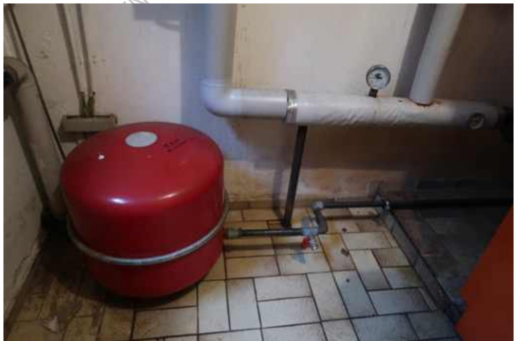
Heizungsraum mit Feuchtigkeitsschäden Sockelbereich
