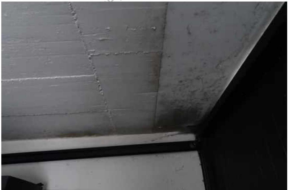
Garagendeckenunterseite mit Feuchtigkeitsschäden innen
