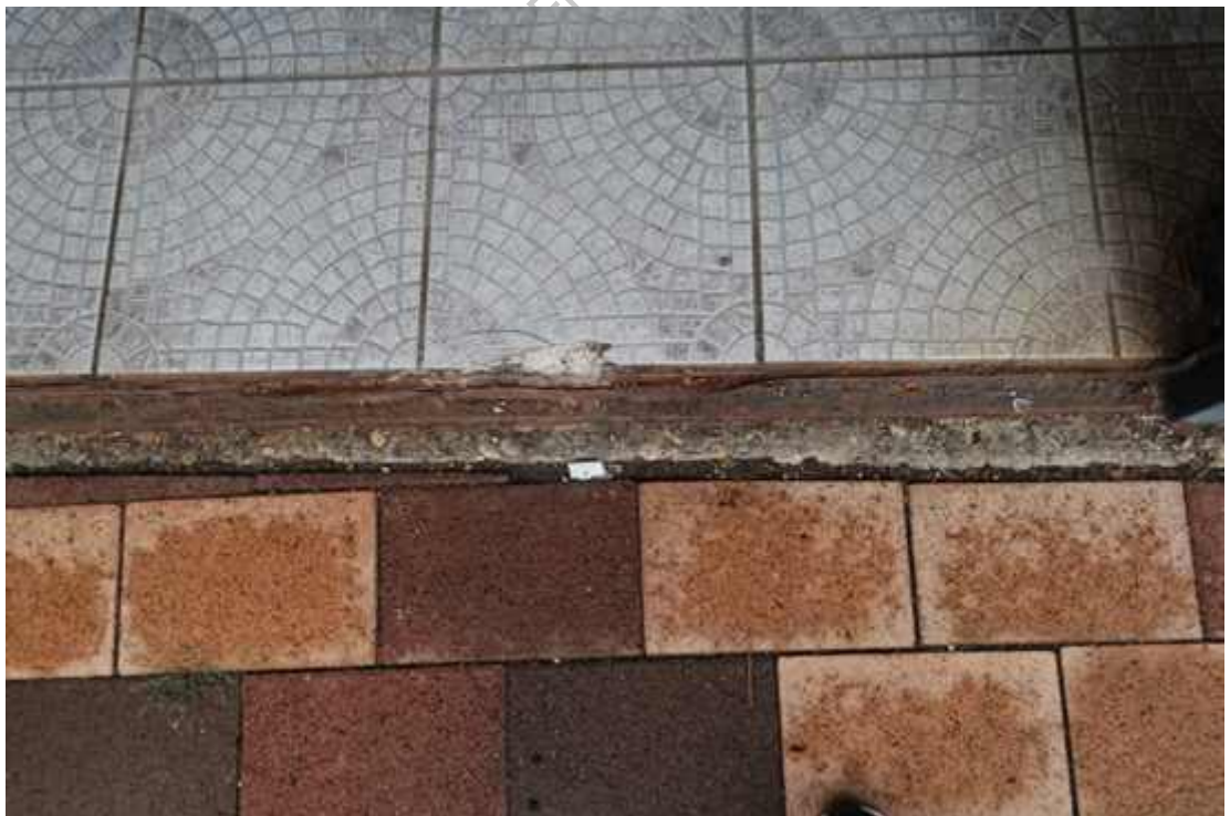
Rostschäden an der Garagenschiene und gesprungene Fliesen
