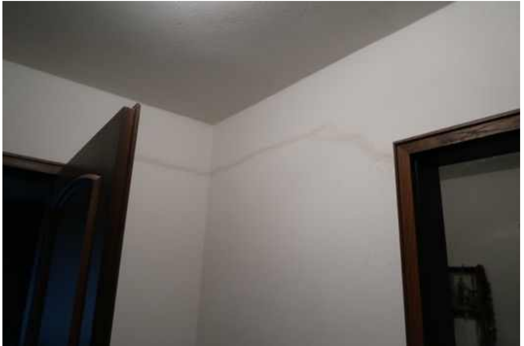
Risse im Zwischenflur und Arbeiten
