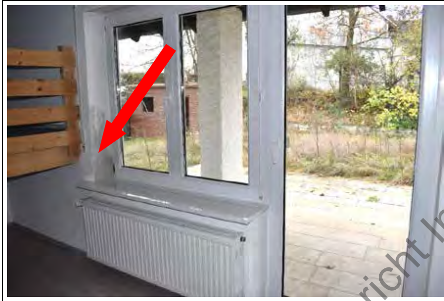
Foto 23: EG, Schlafzimmer, fehlende Anstricharbeiten
