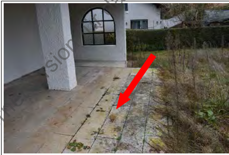
Foto 49: Terrasse 2 (Bereich Wohnhaus) mit beschädigtem Bodenbelag
