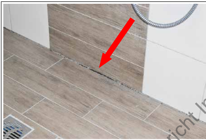
Foto 37: EG, Bad mit offener Fuge
