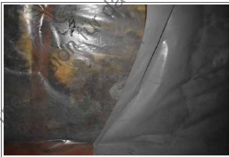
Foto 42: DG, Dachdämmung, augenscheinlich mit Feuchtigkeitsschäden
