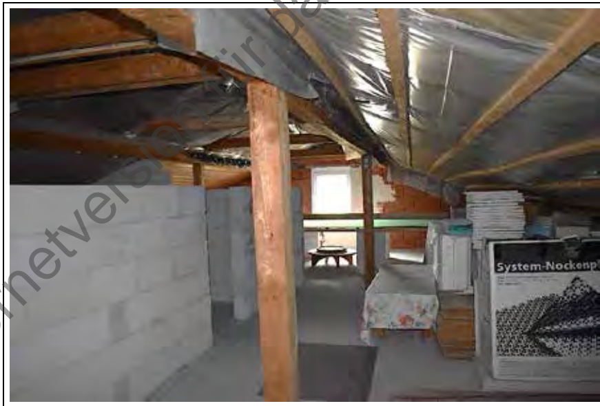
Foto 40: DG mit nicht fertiggestellten Zwischenwänden
