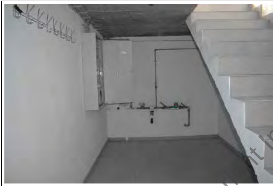
Foto 5: KG, Treppenhaus, Treppe mit fehlendem Geländer
