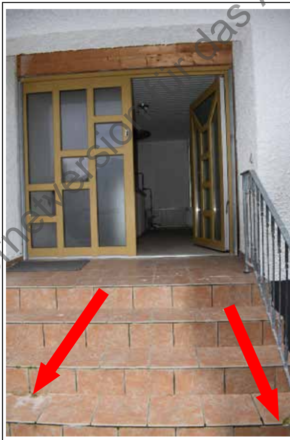
Foto 4: Hauseingangsbereich, Treppe mit beschädigtem Bodenbelag
