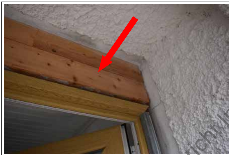
Foto 19: EG, Hauseingangstür außen, fehlende Beiputzarbeiten
