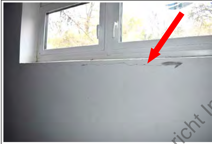
Foto 14: KG, Heizungsraum, Putzrisse
