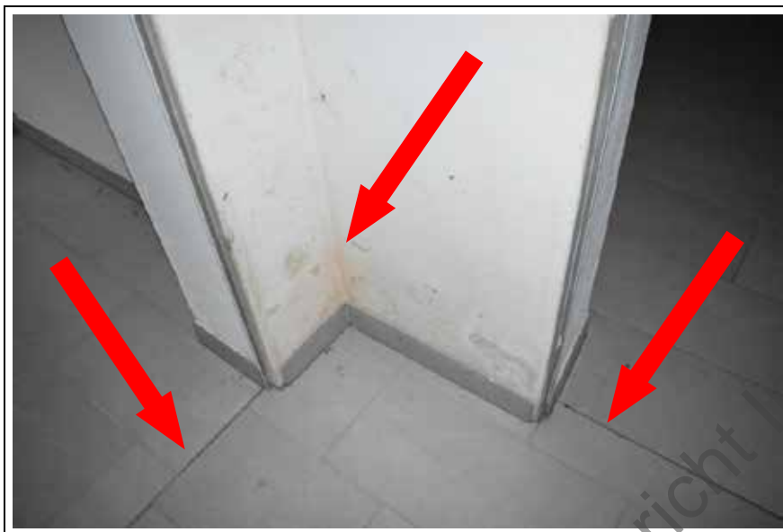
Foto 7: KG, Flur mit Feuchtigkeitsschäden und fehlender Verfugung
