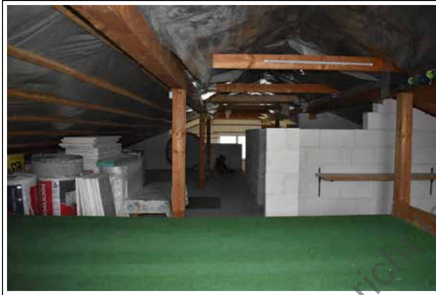
Foto 39: DG mit nicht fertiggestellten Zwischenwänden
