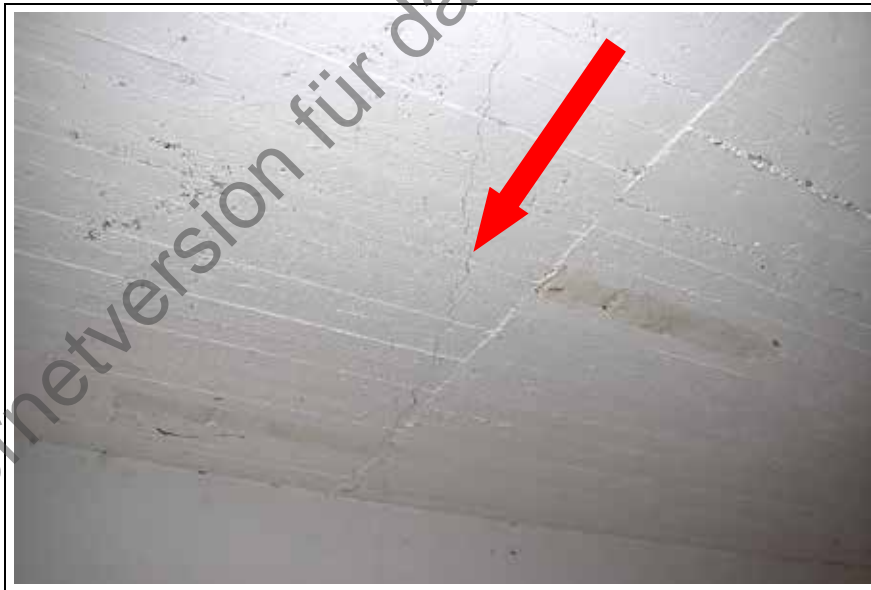
Foto 47: EG, Garage mit Riss an der Deckenuntersicht
