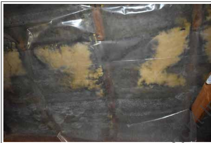
Foto 41: DG, Dachdämmung, augenscheinlich mit Feuchtigkeitsschäden
