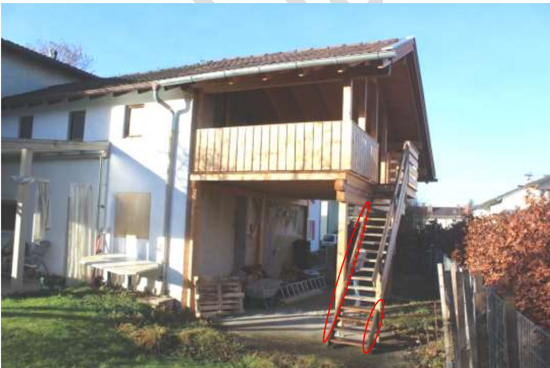
Abb. 2: Nordostansicht Anbau, Treppengeländer mit unzureichender Absturzsicherung
