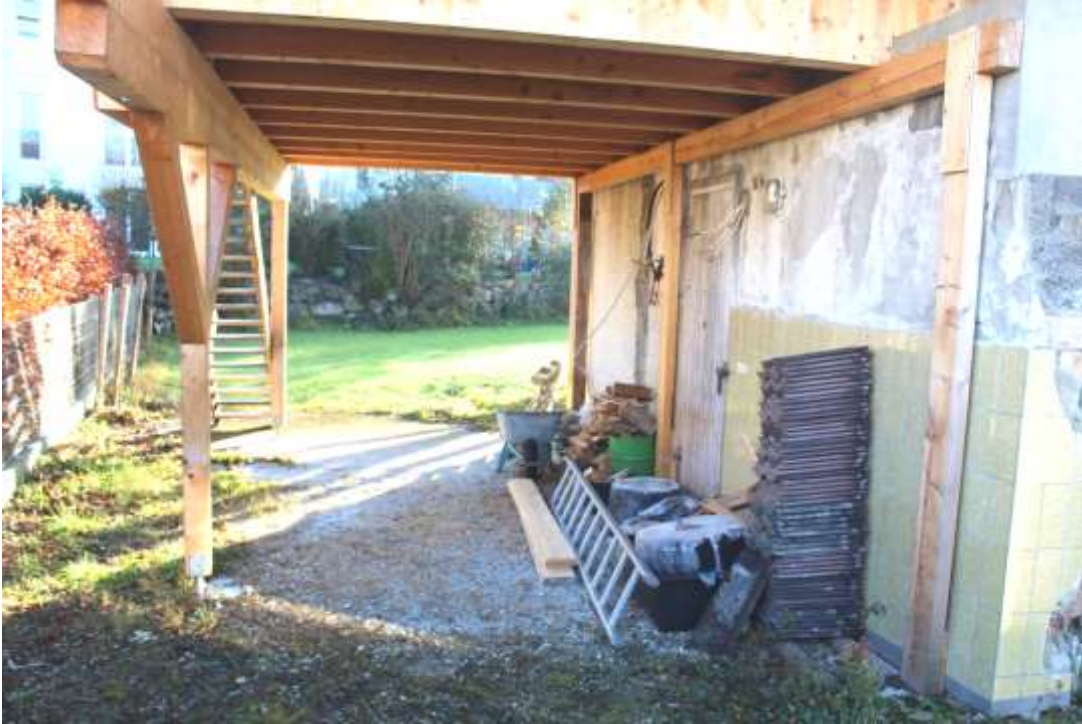
Abb. 1b: Anbau mit Unterstand, Restfertigstellungsbedarf, freiliegende Kabel/Leitungen
