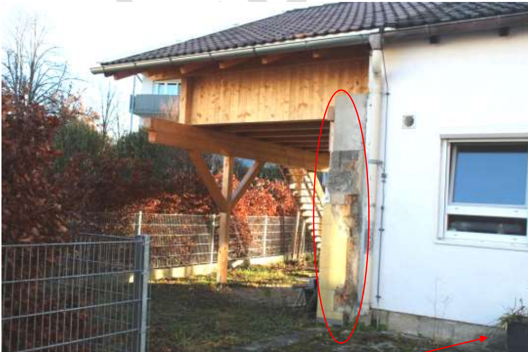
Abb. 1a: Westansicht Anbau – Restfertigstellungsbedarf, Sockelfeuchte (beispielhaft)
