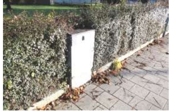
Abb. 16b: Stromverteilerkasten an der südlichen Grundstücksgrenze zur Kolbermoorer Straße
