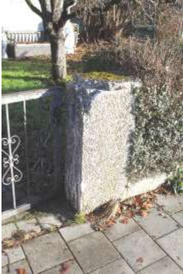
Abb. 15: Defekte Betonsäule (Kolbermoorer Straße)
