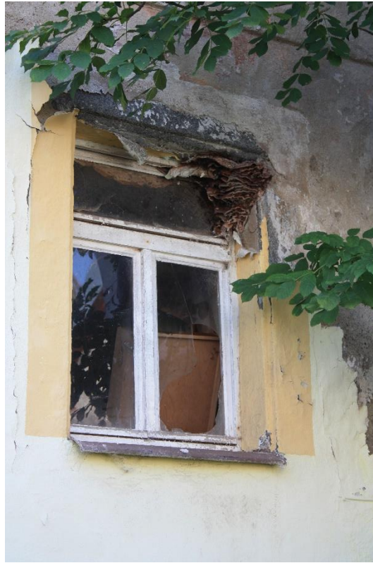
Fenster im Erdgeschoss mit Wespennest
