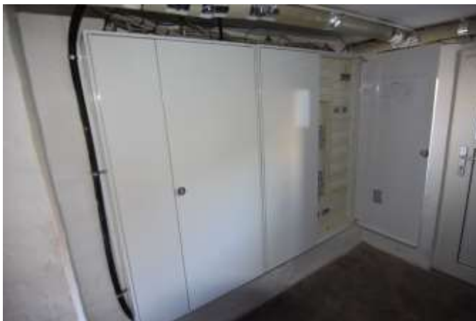
Kellergeschoss, Zählerschränke Strom
