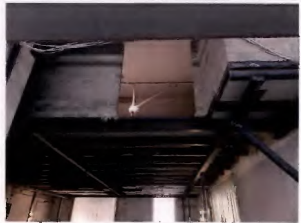
nicht fertiggestellte Zwischendecke
