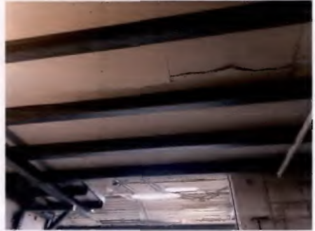
defekte Schalplatten mangelnde Standsicherheit OG
