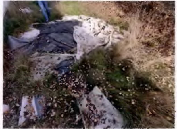
tlw. ausgetauschte Dachfolie lt. Angabe weiterhin Leckage
