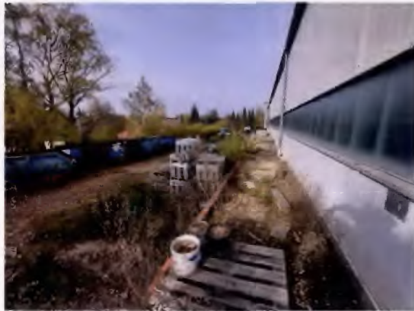
nicht fertiggestellt Laderampe / verwilderte Freifläche
