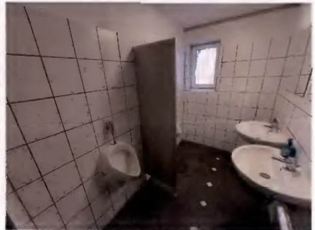
(2) Bürogebäude mit Wohneinheit EG – Herren-WC
