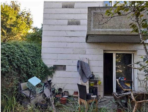
beschädigter Wetterschutz an Westgiebel
