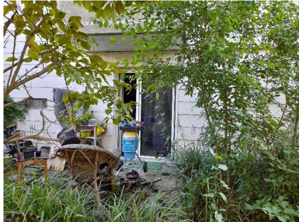
verwachsene Außenanlagen am Westgiebel
