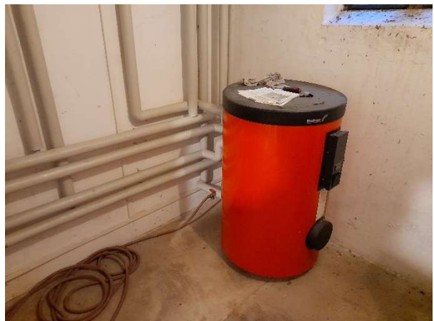
Kellergeschoss – Warmwasserkessel ca. 200l
