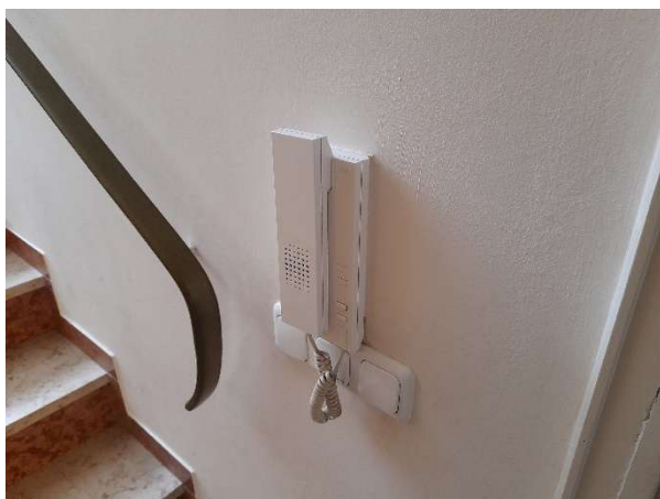
Erdgeschoss – Diele – Türöffner mit Gegensprech-anlage
