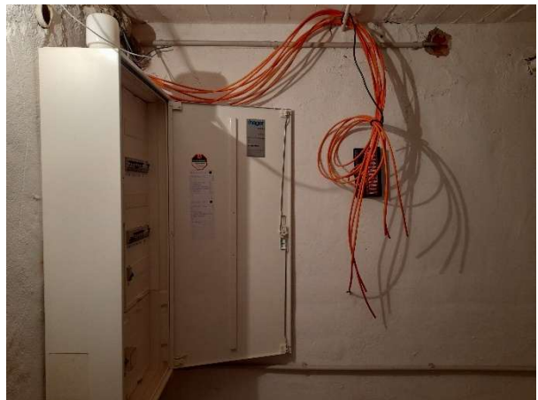
Unterverteilerkasten Strom mit Internetverkablung
