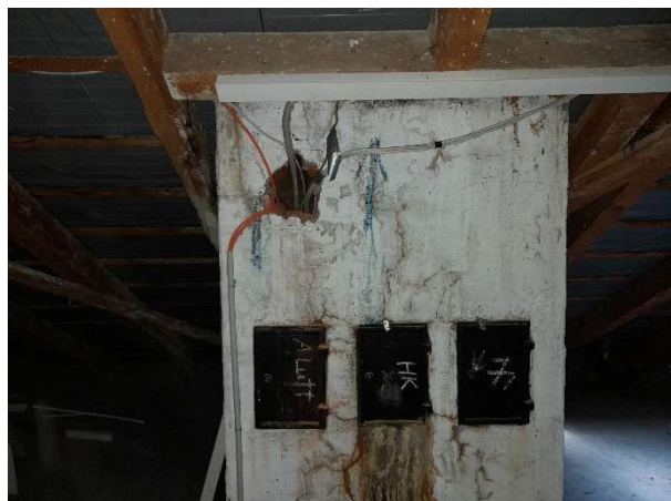
Esse mit provisorischen Kabelschacht
