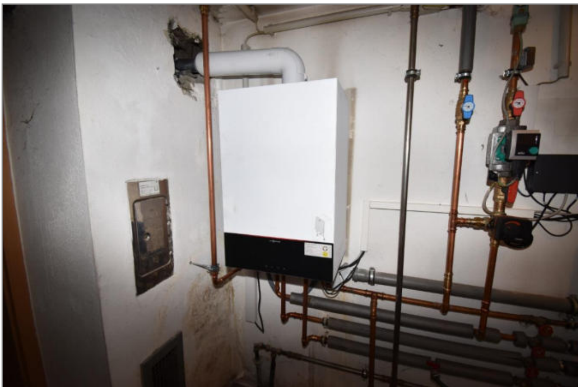
Wohnhaus, KG, Heizungsanlage im Heizungsraum
