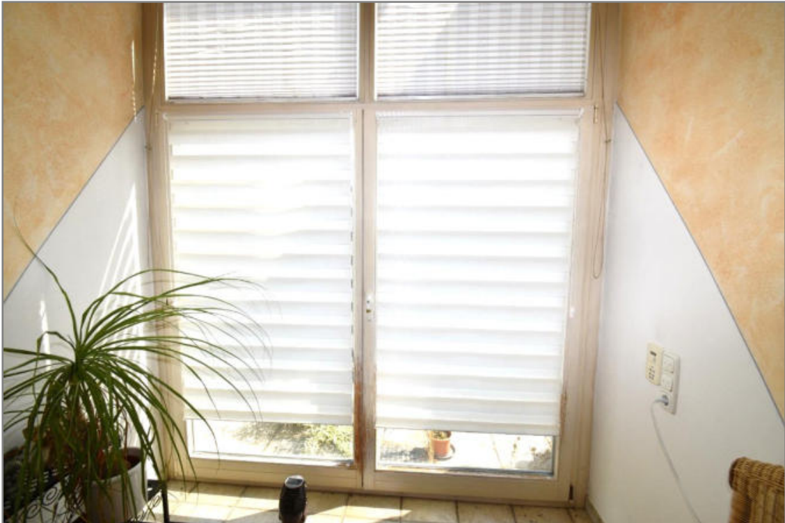
Wohnhaus, EG, Fensterfront im Flur, schadhaft
