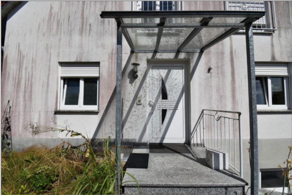
Blick nach Osten auf den Hauseingang an der westlichen Giebelseite des Wohnhauses
