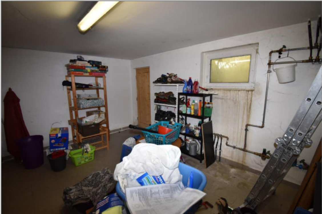
Wohnhaus, KG, Waschküche mit Rückständen von Feuchtigkeitseindringungen
