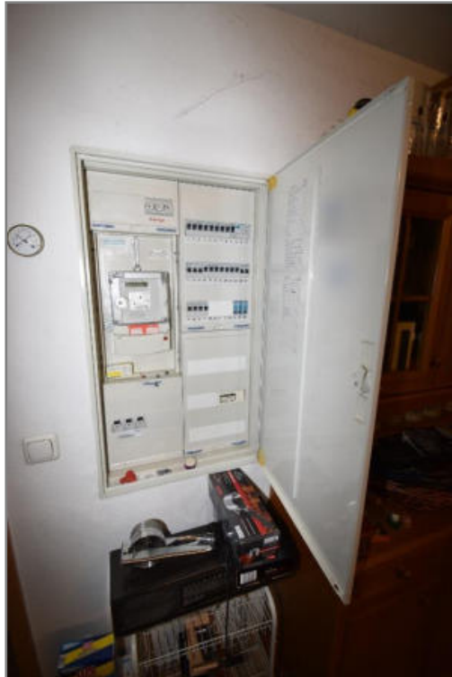
Wohnhaus, KG, Zähler-/Sicherungskasten im Keller 1
