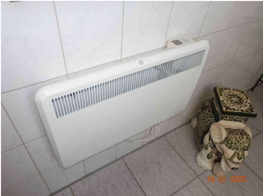
Abbildung 33: Elektrische Wandheizkörper in allen Wohnungen
