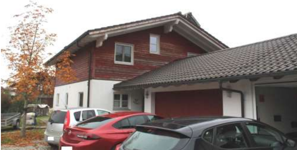
Abb. 5: Westansicht – Schalung und Windläden verwittert, anstrichbedürftig (beispielhaft)
