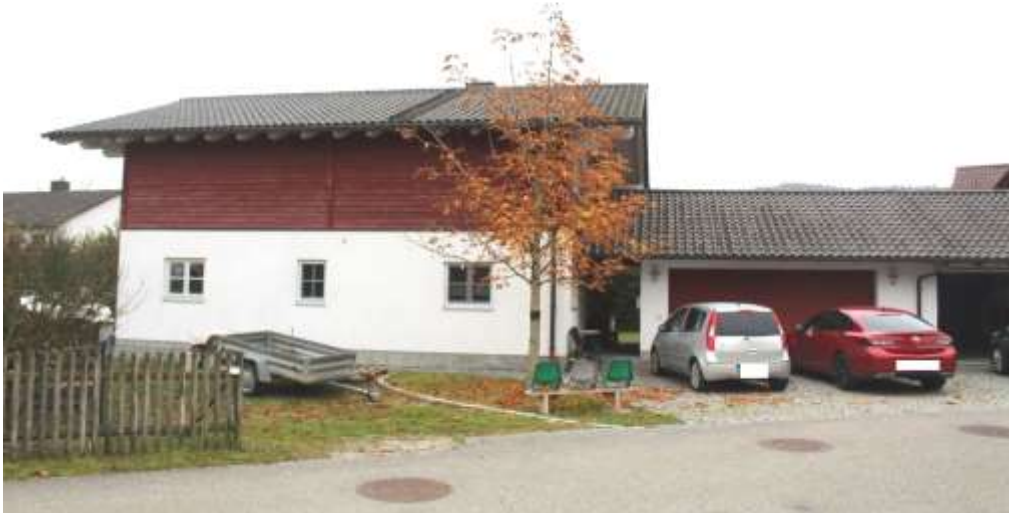
Abb. 1: Nordansicht Einfamilienhaus und Doppelgarage – Schalung anstrichbedürftig (beispielhaft)
