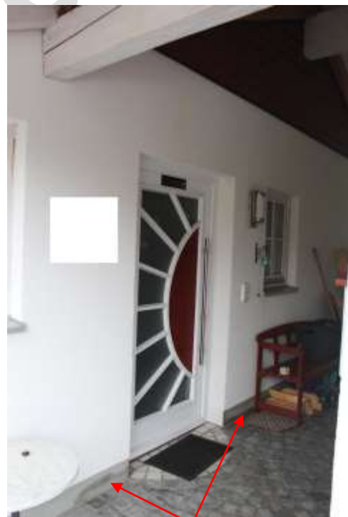
Abb. 7: Haustür, Sockel augenscheinlich feucht (beispielhaft)
