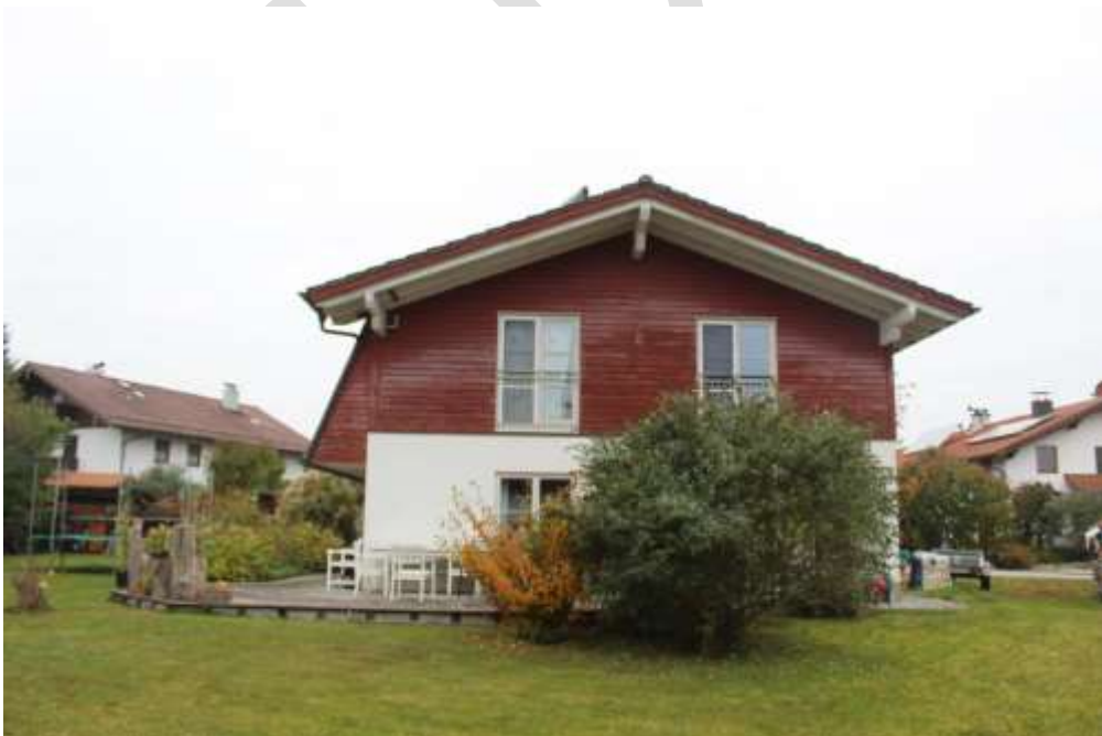
Abb. 2: Ostansicht – Schalung anstrichbedürftig (beispielhaft)
