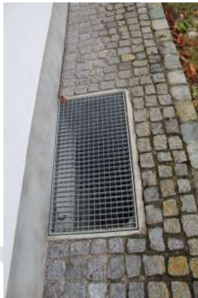
Abb. 10: Kellerlichtschacht, Granitkleinsteinpflaster, Sockel augen- scheinlich feucht (beispielhaft)
