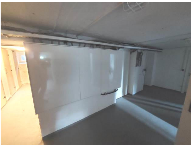
Kellergeschoss neue Elektroverteilung
