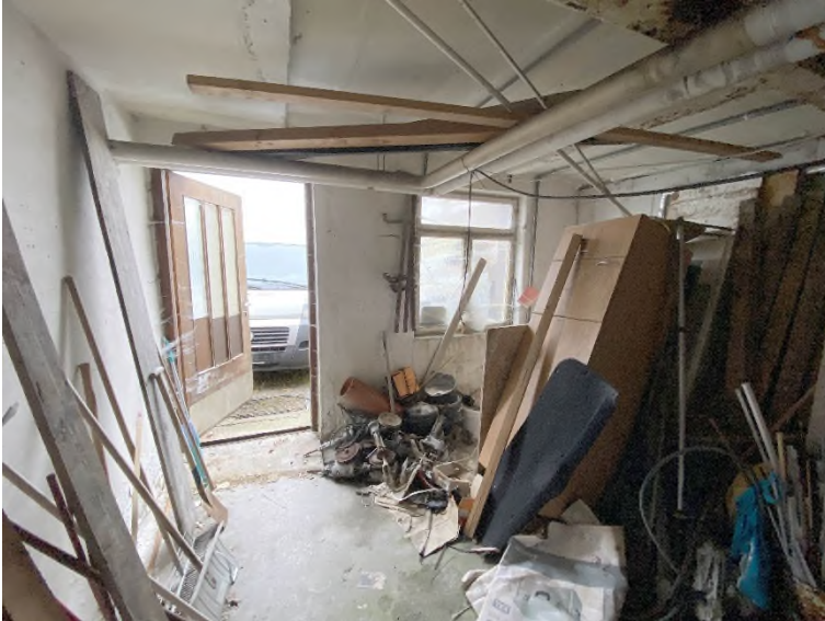
Bild 36 – Vorraum Heizung (R8)
