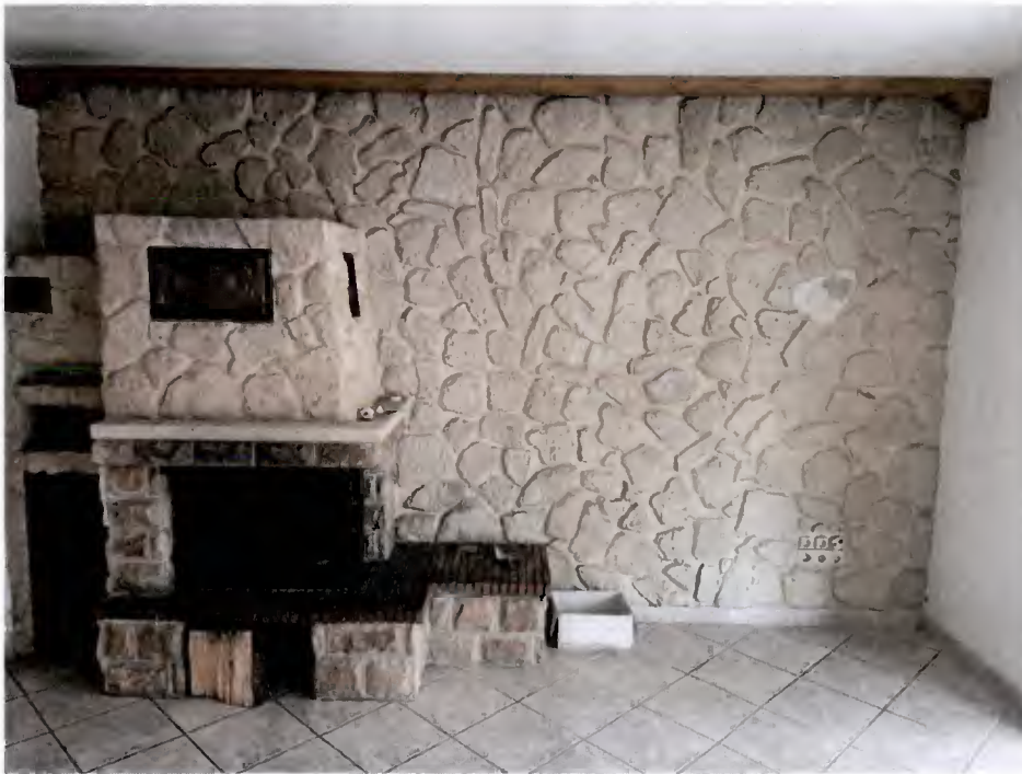
Wohnzimmerwand mit Steinbelag (Fehlstellen) und Kamin (darf nicht mehr benutzt werden)
