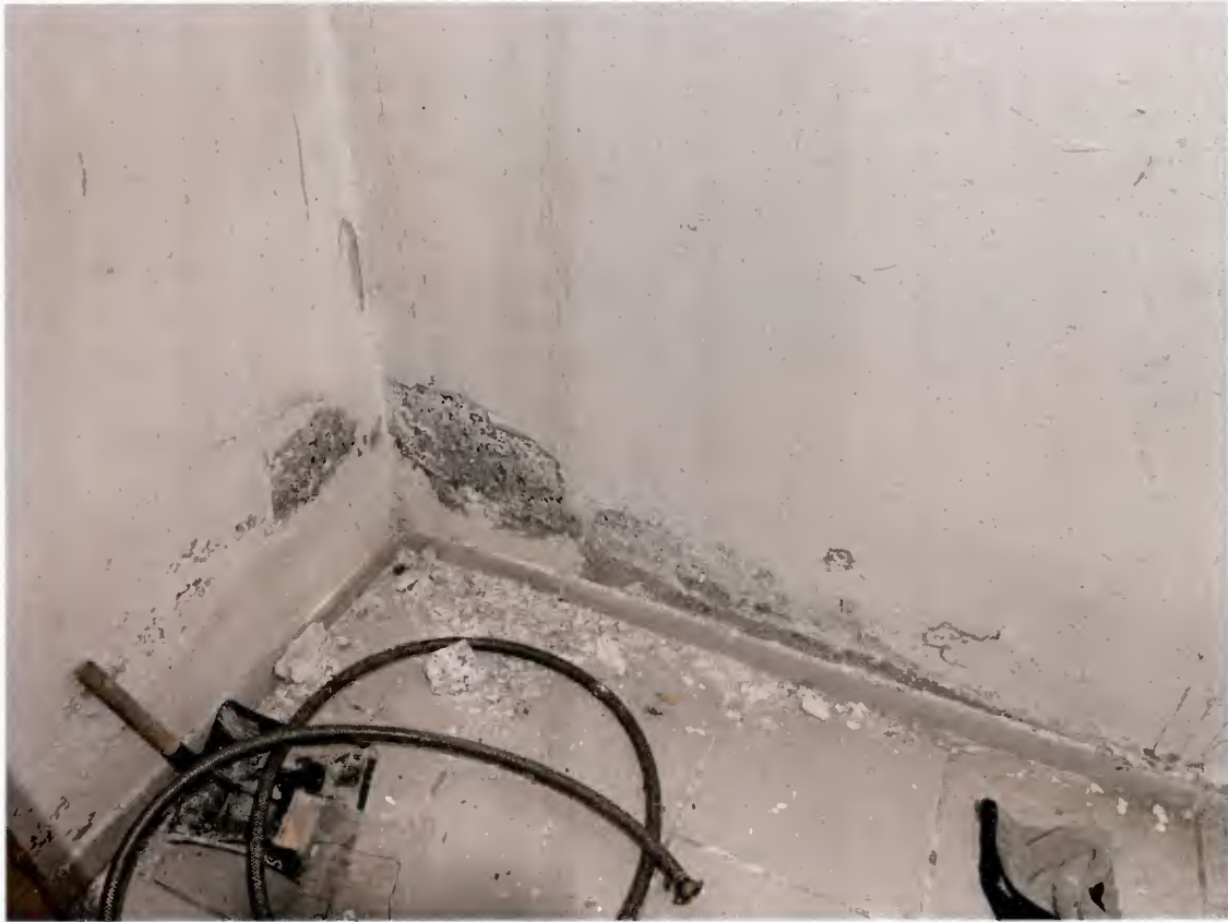
Feuchteschaden im Kellergeschoss
