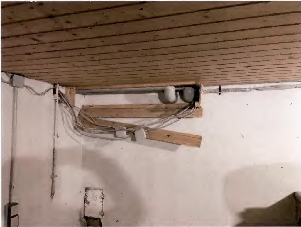
Schadhafte Holzdecke im Hobbyraum im Kellergeschoss
