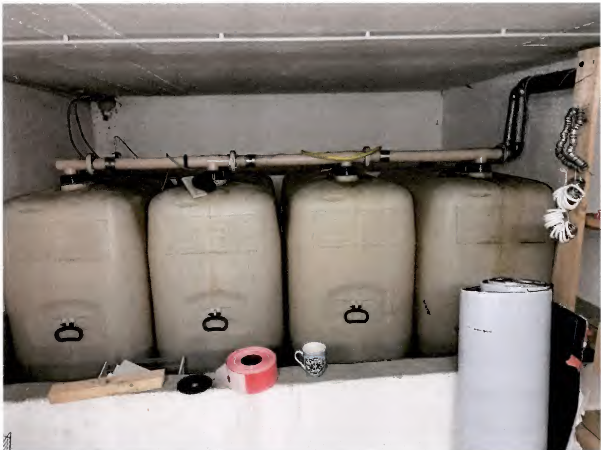
Öltanks mit Aufkantung im Kellergeschoss
