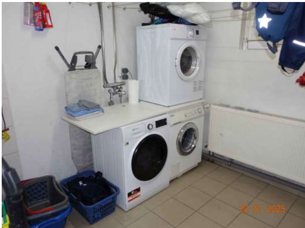
Abbildung 16: Waschkeller mit Heizkörper
