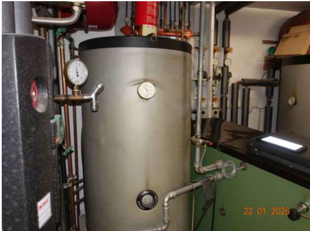
Abbildung 15: Warmwasserbehälter der Holzscheitheizung und der Solaranlage
