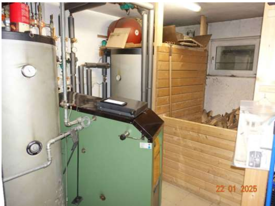
Abbildung 14: Holzscheitheizung mit Holzlagerfläche
