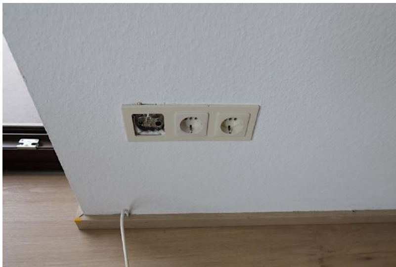
Elektroinstallation, Detail, Zustand
