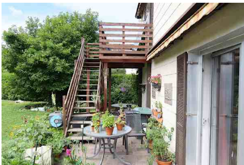
Balkon, Schutzanstrich verbraucht, Holzgeländer stellenweise morsch
