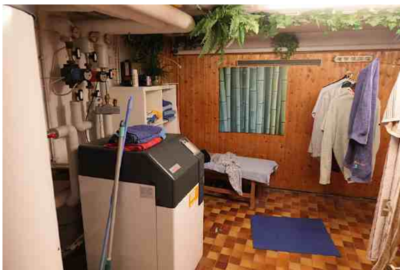
Heizungskeller mit Waschküche, Sauna und Dusche
