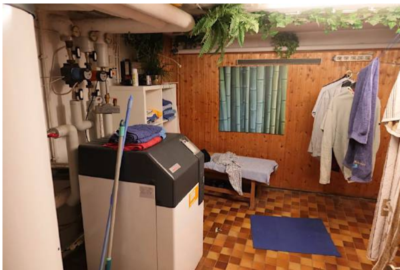
Heizungskeller mit Waschküche, Sauna und Dusche
