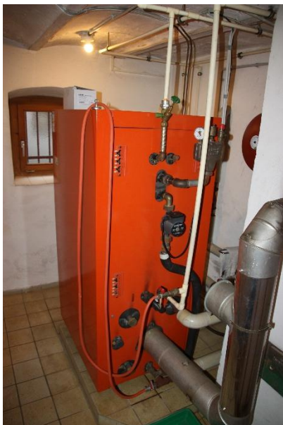
Heizzentrale im Stall
