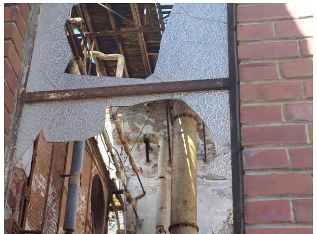
zerbrochene Fenster am Kesselhaus
