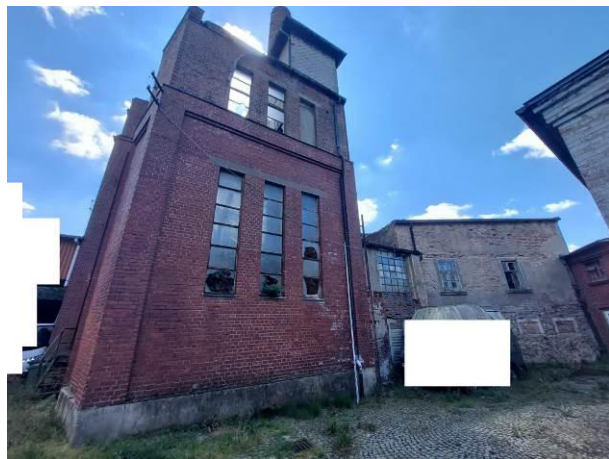
eingebrochenes Kesselhaus mit Nebenbau
