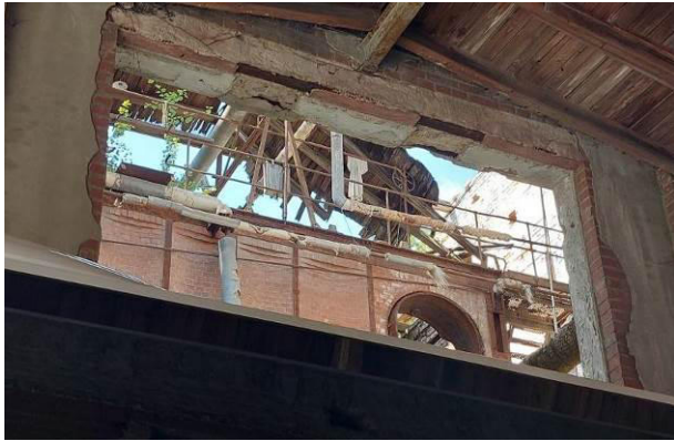
Durchbruch Außenwand Kesselhaus / eingebrochenes Dach
