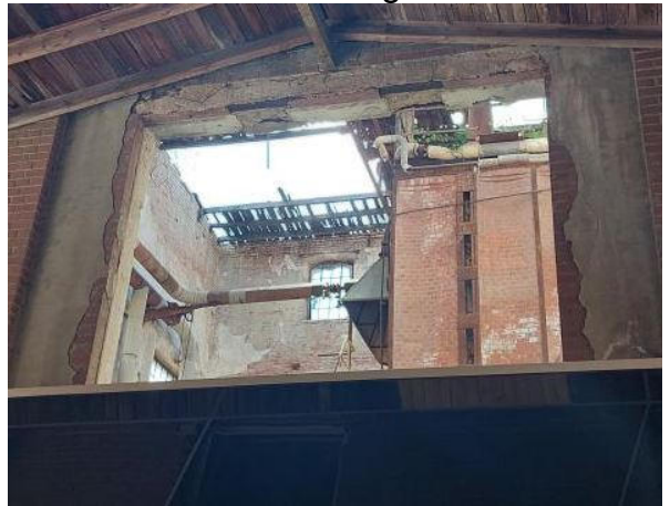
Durchbruch Außenwand Kesselhaus / eingebrochenes Dach
