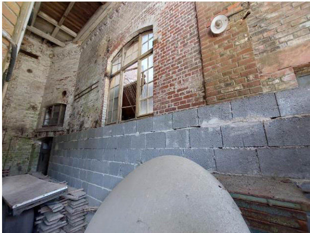
Zugang Süd-Ost-Seite Nachbarschaftsgrundstück zugestellt
