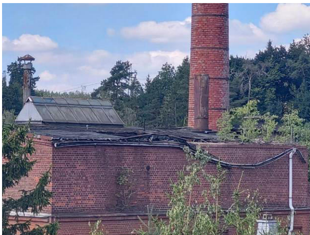
eingebrochenes Dach / Mauerwerk mit Bewuchs
