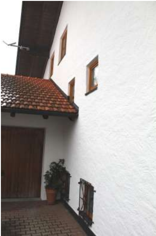
Abb. 2: Detailaufnahme Westfassade – vom Plan abweichende Fenstergestaltung
