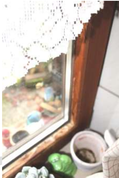
Abb. 21c: Bad Fensterrahmen - Wasserspuren beispielhaft
