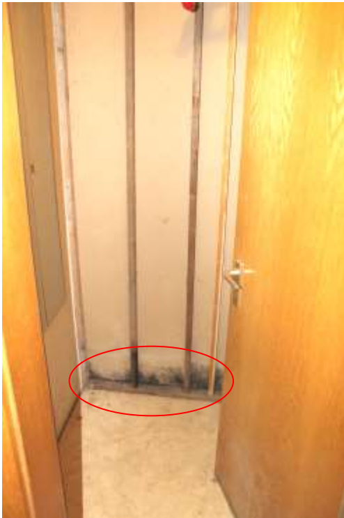
Abb. 23: Zählerraum, Feuchtigkeit, pilzig
