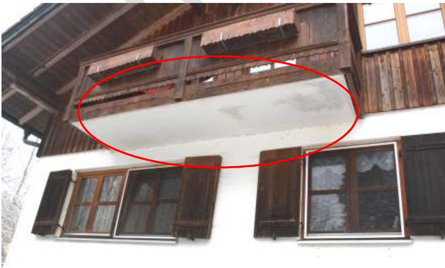
Abb. 7: Balkon Ostseite, vom Plan abweichende Ausführung - Feuchtigkeitsschäden
