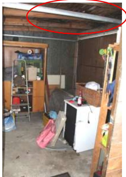
Abb. 48b: Feuchtigkeitsschaden Decke beispielhaft
