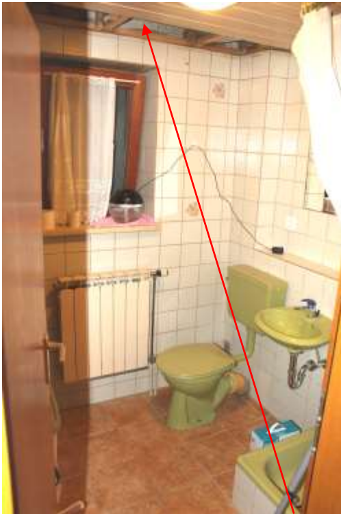
Abb. 16a: Duschbad (älter), fehlende Deckenverkleidung
