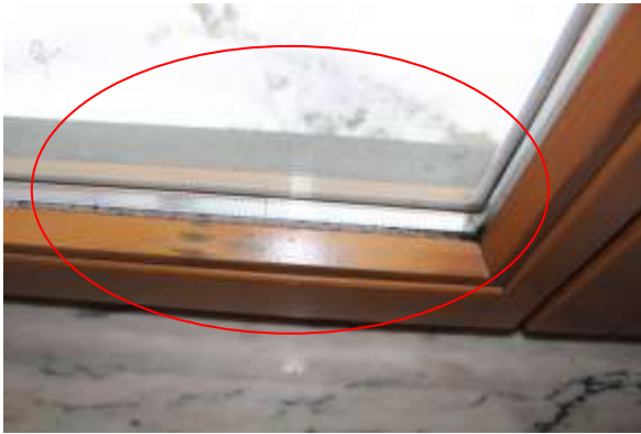
Abb. 39b: Fensterrahmen Wasser- spuren Schlafzimmer, pilzige Silikonfugen
