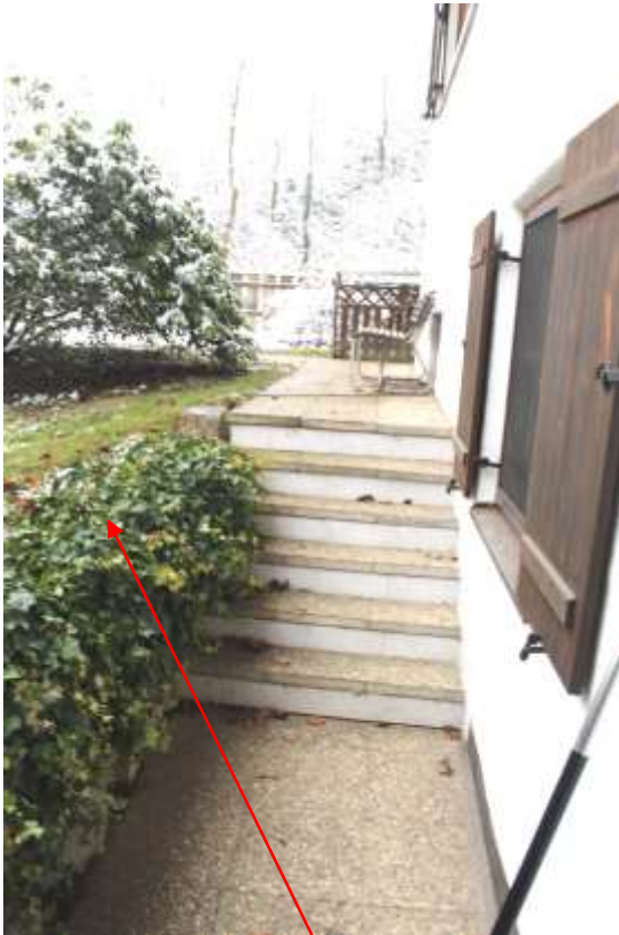
Abb. 5: Ostseite Zugang zur Wohnung Keller/Sockelgeschoss, fehlende Absturzsicherung
