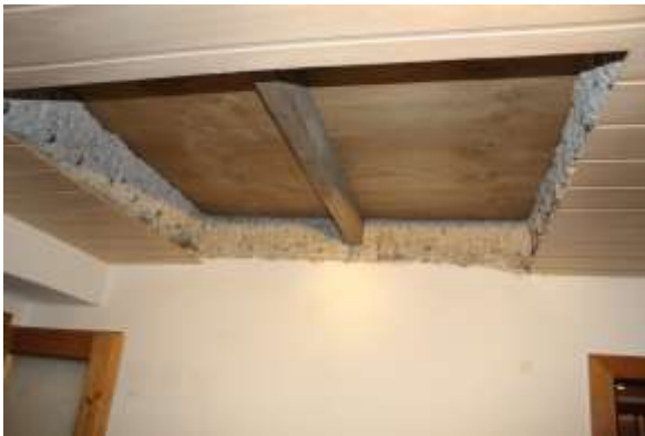
Abb. 14: Abstellraum – Deckendurchbruch, provisorisch verschlossen
