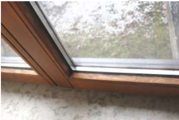
Abb. 18: Schlafzimmerfensterrahmen innen Wasserpuren (beispielhaft)
