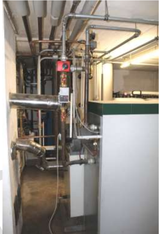
Abb. 25: Heizraum, nur teilweise Rohrisolierung
