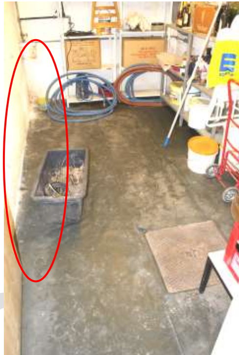
Abb. 28: Lagerraum mit Bodenschacht, Feuchtigkeitsschäden (beispielhaft)
