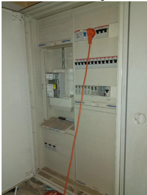
Stromzähler mit Sicherungen im KG
