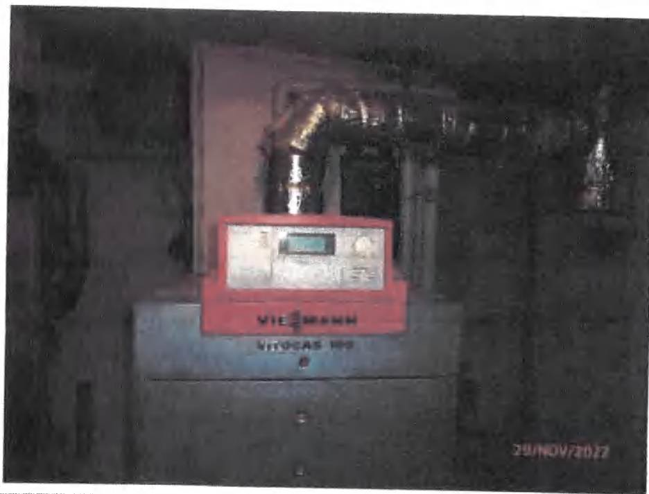
Bild 6: Gasbrennwertgerät (Heizung) im Jahr 2015 modernisiert
