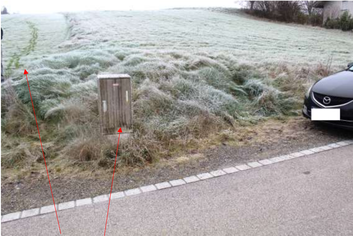
Abb. 7: FlNr. 67/7, Stromverteilerkasten in der Nähe der südwestlichen Grundstücksgrenze an der Gartenstraße
