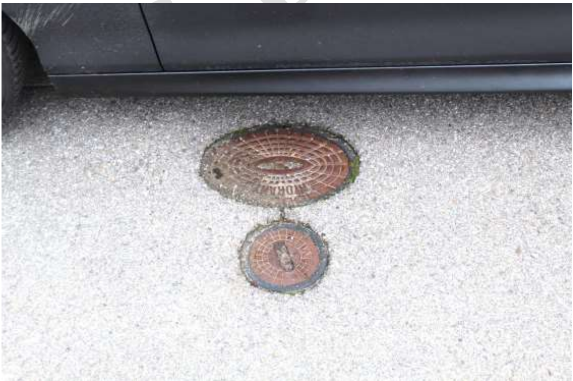
Abb. 2: Wasser-/Hydrant-Anschluss vor dem Bewertungsgrundstück in der Gartenstraße
