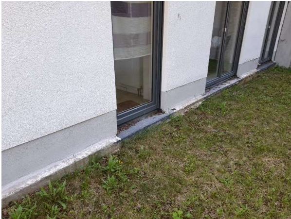
Bewertungsobjekt fehlende Terrasse
