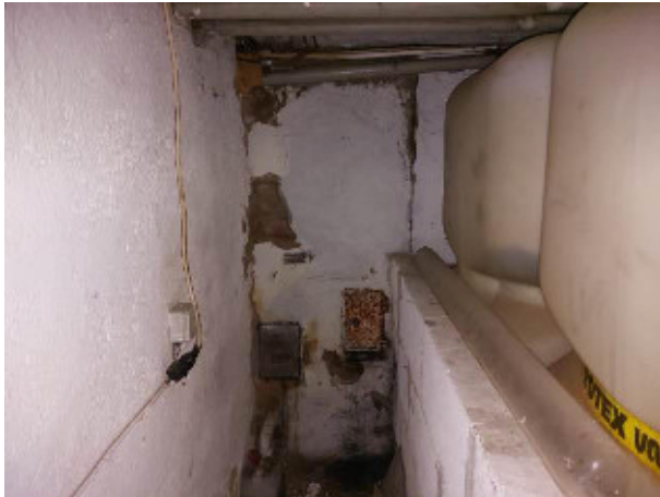
Feuchtigkeits-, Putz- und Mauerwerksschäden
