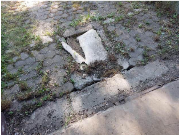
schadhafte Freifläche und defektes Garagentor
