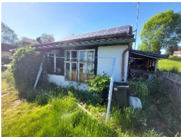
Holzverschlag zum Abriss / schadhafte Fenster
