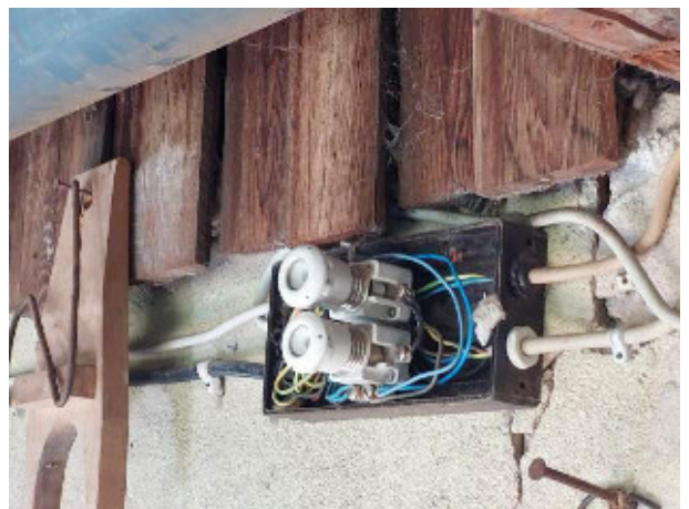
Schuppen elektrische Verteilung
