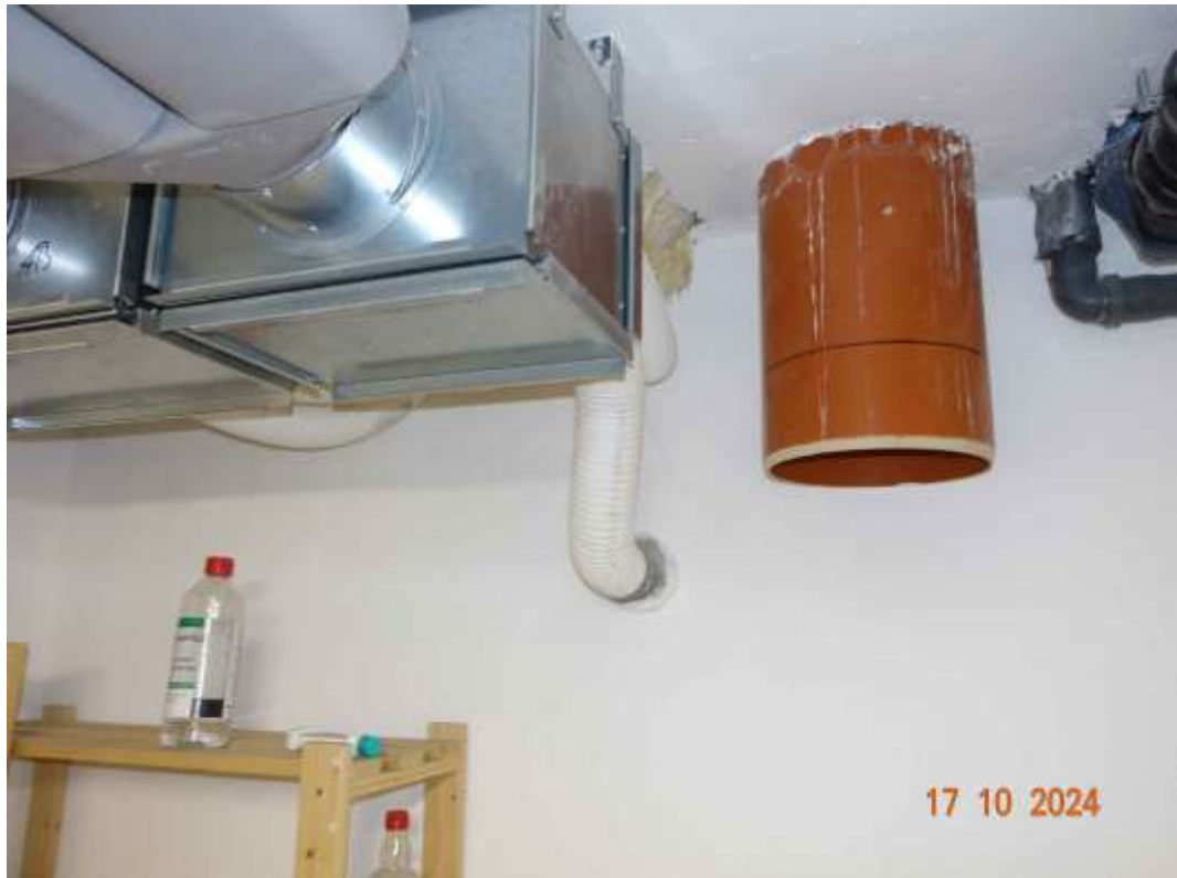
Abbildung 19: Wäscheabwurfschacht im Waschkeller
