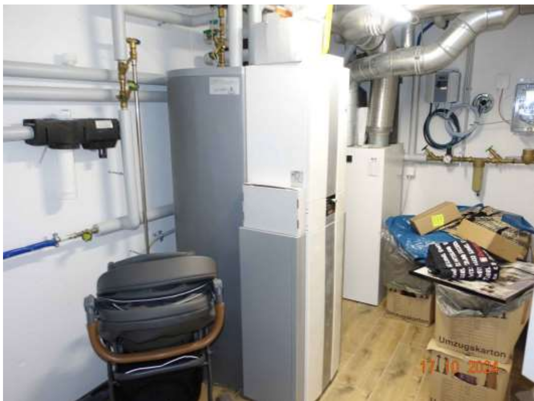
Abbildung 20: Heizungs- und Technikraum
