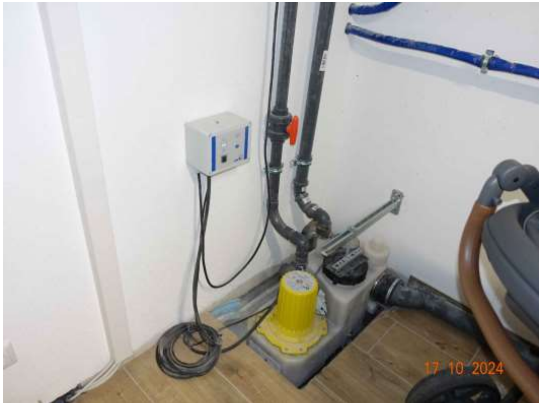
Abbildung 21: Hebeanlage im Waschkeller
