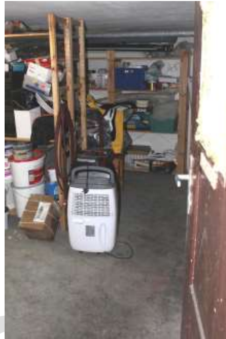
Abb. 36: Abstellraum, Schutzanstrich rissig (beispielhaft)
