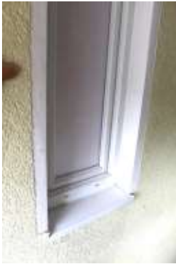
Abb. 8: Fenster provisorisch verschlossen
