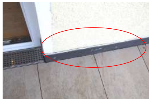
Abb. 22a: Balkon, Acorinne, Zustand Silikonfuge
