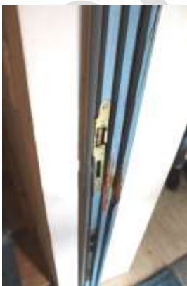
Abb. 9a: Defekte Zarge
