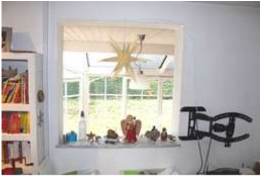
Abb. 15a: „Fenster“ Wohnzimmer in den Wintergarten, Absturzsicherung fehlt
