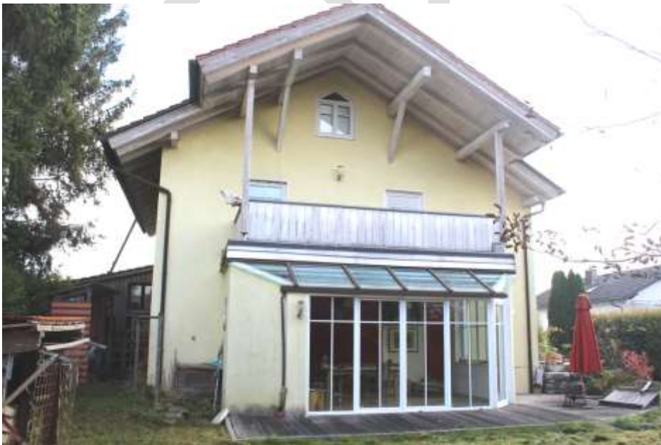
Abb. 3: Westansicht, Wintergarten, Zustand Fassade u. Holzteile
