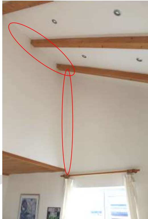
Abb. 27b: Kinderzimmer – Anschlussfugen gerissen (beispielhaft)
