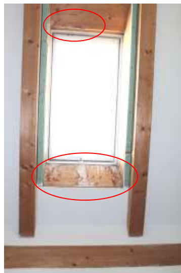
Abb. 26b: Wasserspuren Dachflächenfenster
