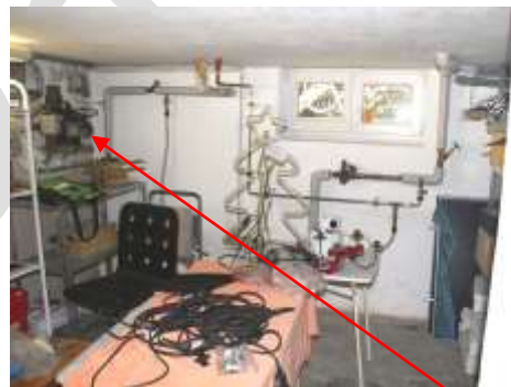
Abb. 34: Abstellraum mit Wasserwerk
