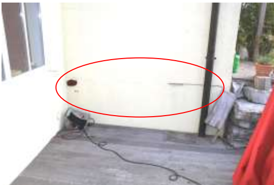
Abb. 3b: Fassadenschäden Westseite
