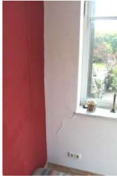
Abb. 14b: Mauerriss, beispielhaft
