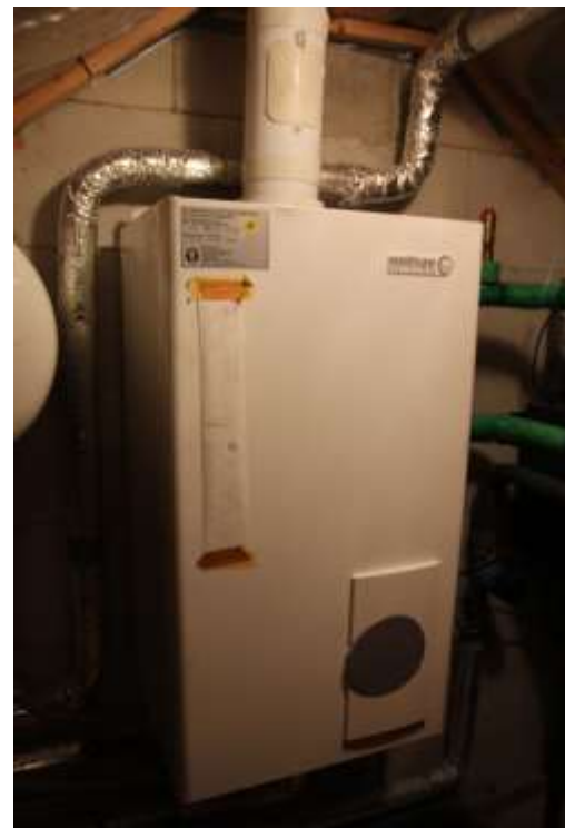
Gastherme im Speicher
