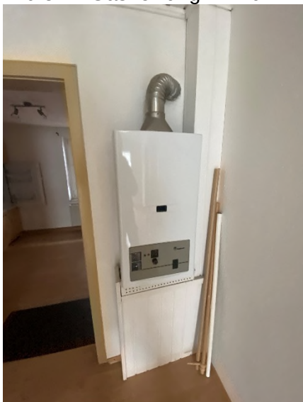
Bild 51 – Gasheizung im Flur
