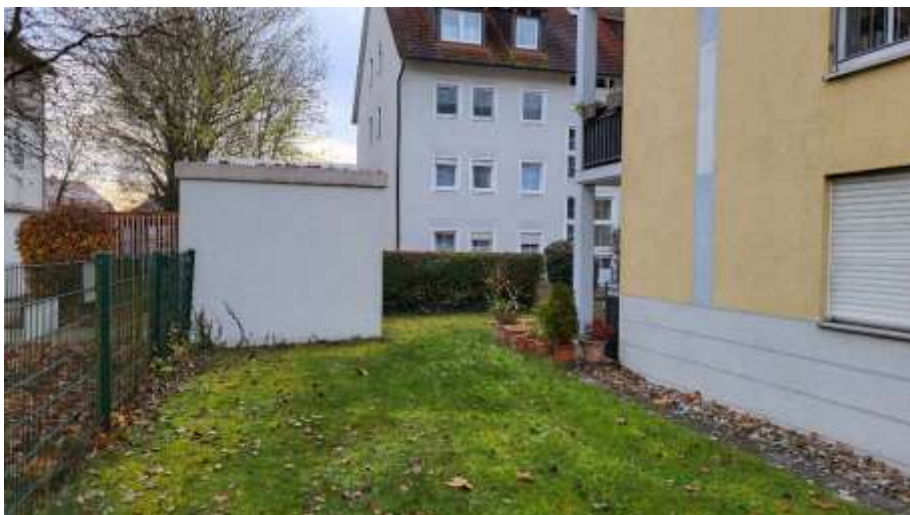
Trafostation in der südlichen Grundstücksecke
