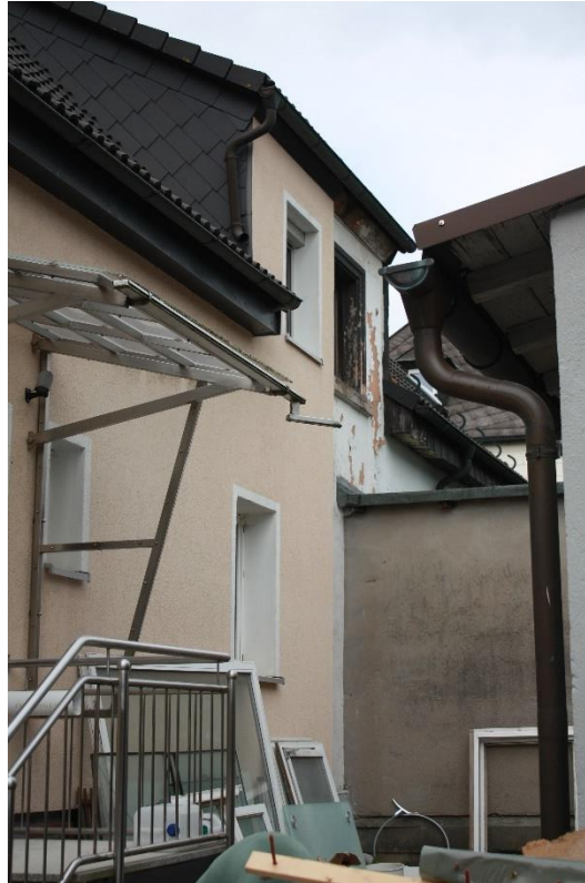
Putzschäden am Fenster der Dachgaube des Wohnhauses
