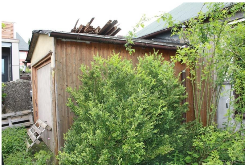
Die Garage (im Lageplan A) ist abbruchreif.
