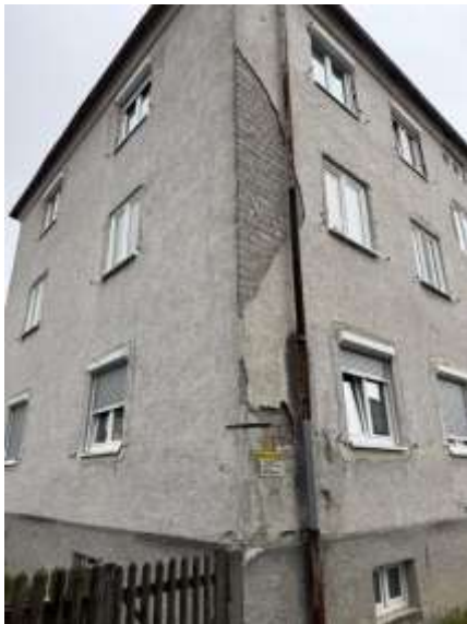
Detail Fassade (Putzschäden)
