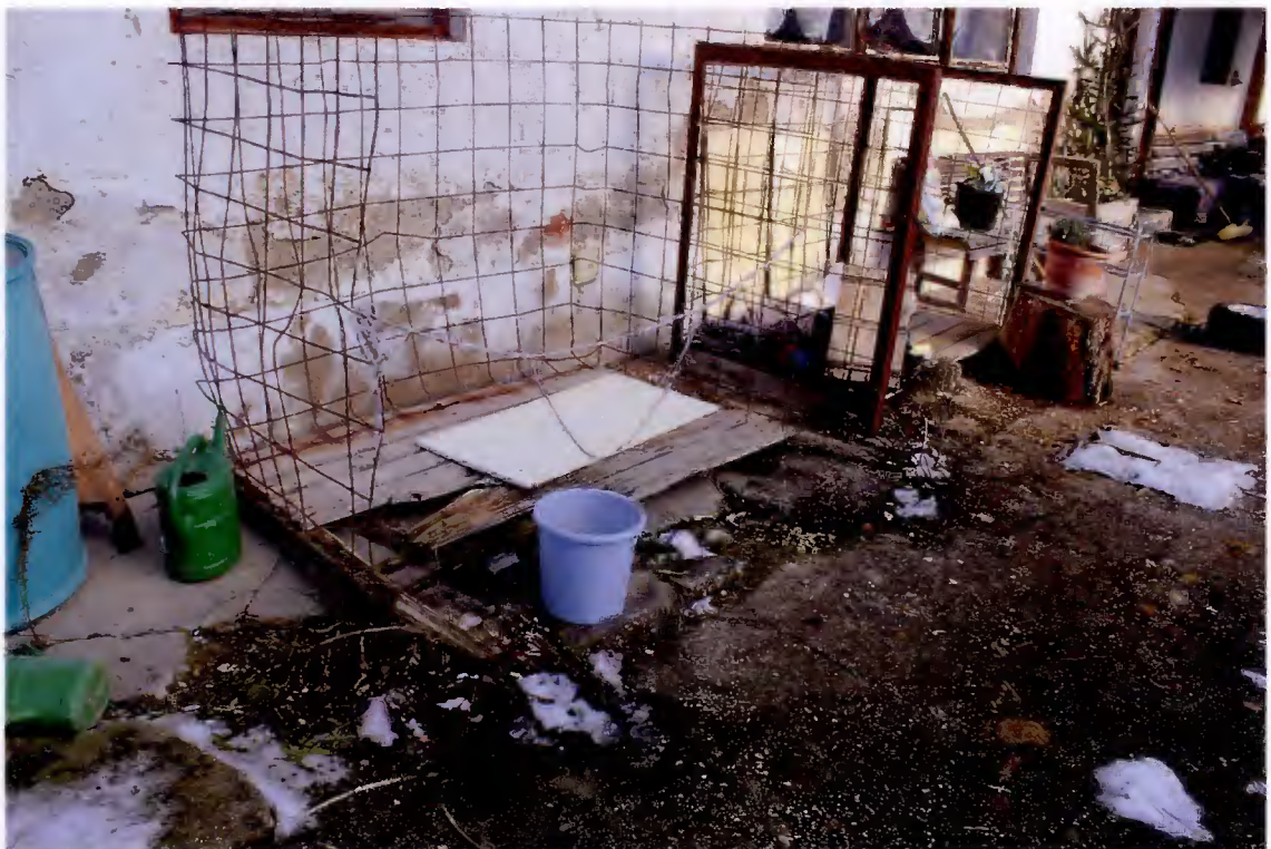
Fassade (Mauerwerksschäden) und Außenanlagen, Detailansicht
