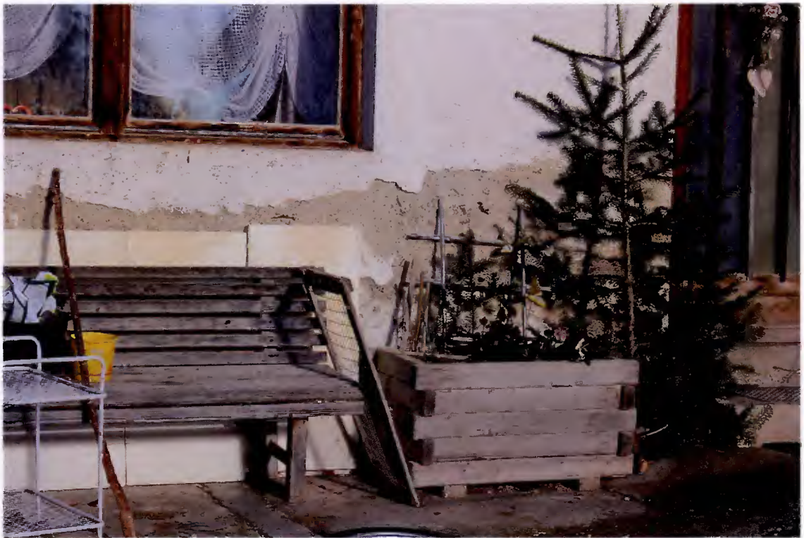
Fassade Mauerwerksschäden, Detailansicht
