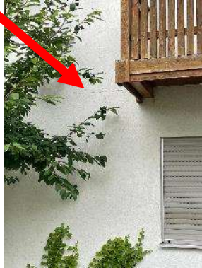
beispielhafte Ansicht des Fassadenrisses an der Gebäude-Ostseite
