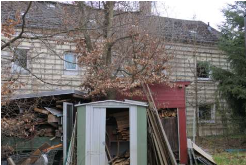
Bild 3: Gebäuderückseite. Grundstücksgrenze bildet die Außenmauer des Gebäudes. Die Schuppen und Bäume befinden sich auf dem Flurstück 482/3 (Nachbargrundstück)
