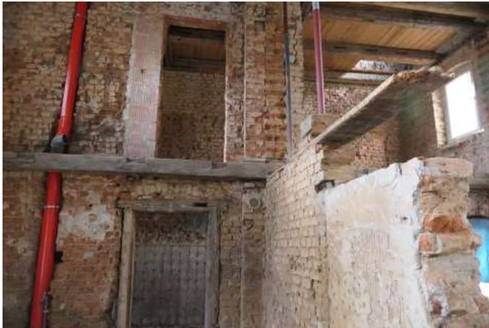
Bild 9: im Wohnhaus (keine Decke und Innenwände)
