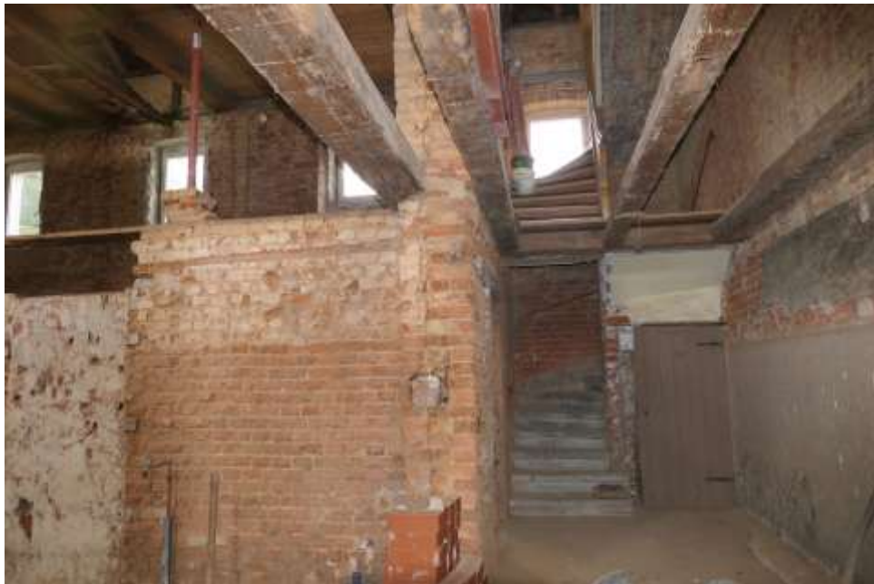
Bild 8: im Wohnhaus (keine Decke und Innenwände)
