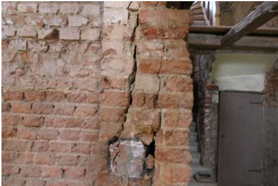
Bild 10: Mauerwerksrisse im verbliebenen Mauerwerk
