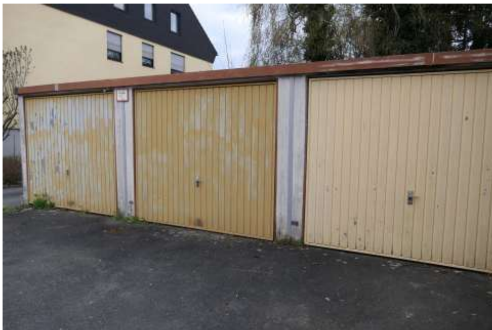
Bild 6: drei Fertiggargen im schlechten baulichen Zustand
