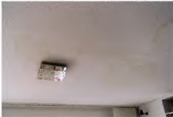
Wasserflecken an der Decke im Wohnzimmer
