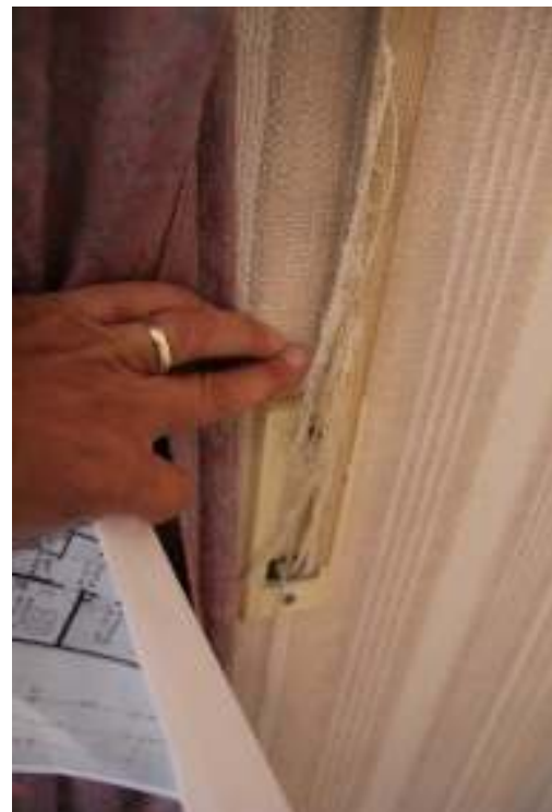
Detailansicht defekter Gurt Jalousien
