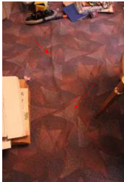
Detailansicht Teppichboden mit Aufwölbungen Kinderzimmer Obergeschoss
