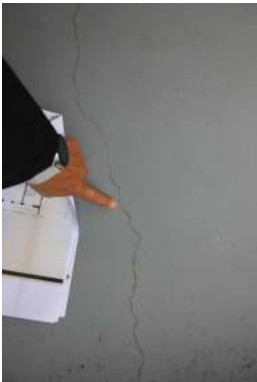
Riss Bodenplatte Balkon
