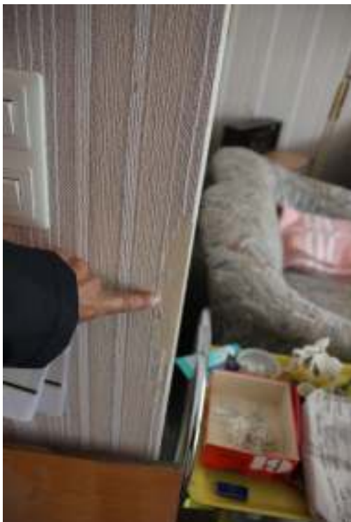
Detailansicht Beschädigung Tapete Wohnzimmer
