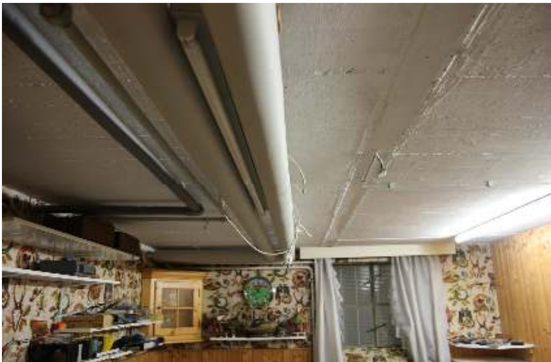
Kellerraum mit abgedämmten Leitungen
