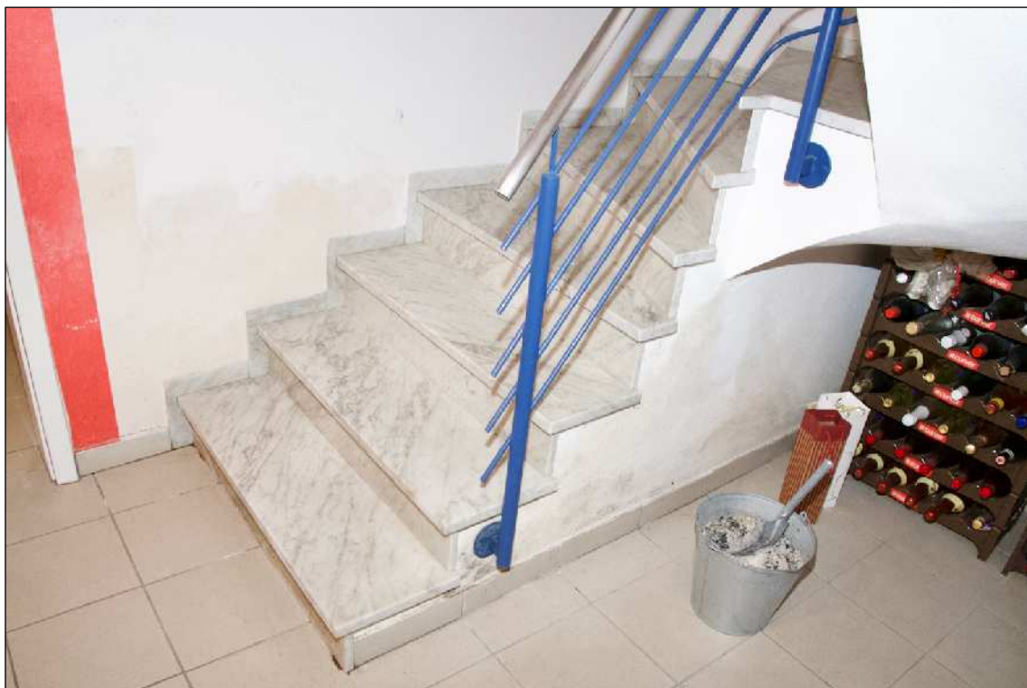
Foto 14 Kellergeschoss - Kellertreppe, Detail aufsteigende Feuchtigkeit
