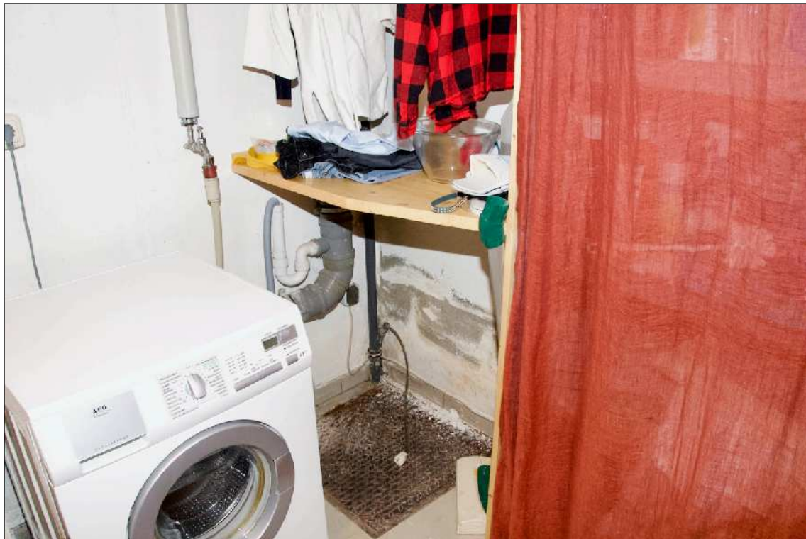
Foto 13 Kellergeschoss - Waschküche, Detail aufsteigende Feuchtigkeit
