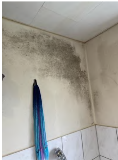
Schimmelbildung Bad (EG)
