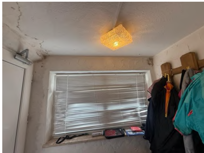
Schimmelbildung Eingangsbereich (EG)
